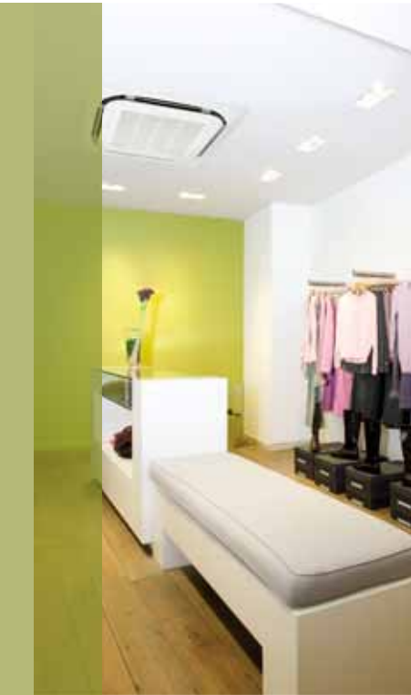
Rund strømningskassett montert i himling
